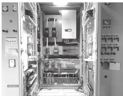
▲東中島地区第1号揚水機場 電気設備更新
