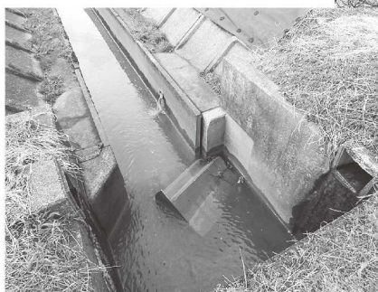
▲水路壁の倒壊（上越市福橋地内）
