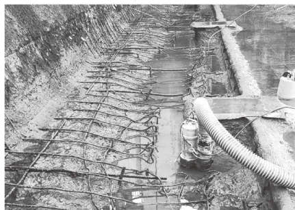
▲団体営基幹水利施設ストックマネジメント事業関川地区 (関川頭首工下流エプロン補修)
