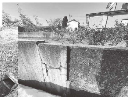
▲水路沈下（上越市大学前地内）
