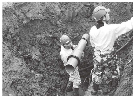
▲上越市小規模災害復旧事業広井地区 パイプライン修繕工事
